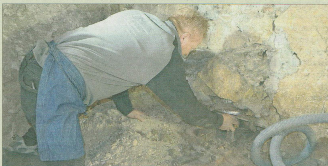
Les pierres utilisées lors d'une précédente restauration n'étaient pas adéquates.
